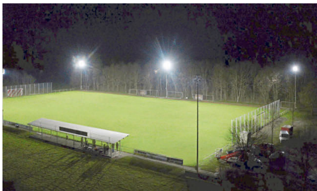
Selbst die Eckfahnenbereiche des Rasenplatzes in Salzkotten-Thüle sind dank der neuen LED-Technik nun optimal ausgeleuchtet.
